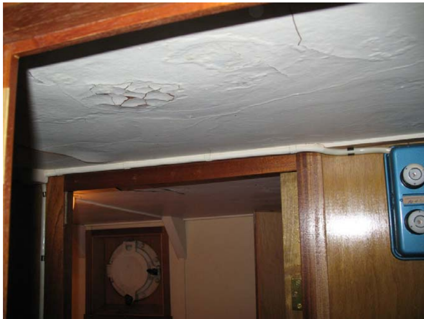
Tegn på lekkasje i platehimling lugarer forut.
