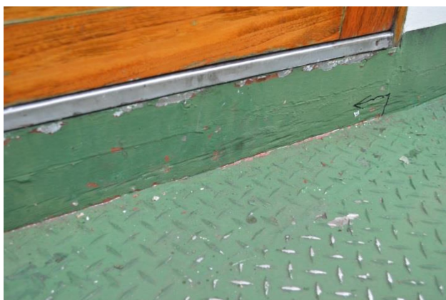
Under dør inn til kontor. Her virker det som sveisen ikke har tak i begge flatene. Altså for tynn.
